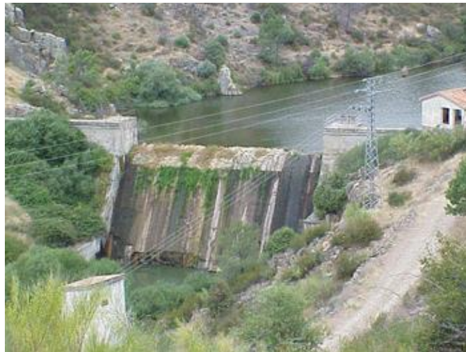
Figure 5. The Robledo de Chavela dam (source: Tajo River Basin Authority – Confederación Hidrográfica del Tajo).
